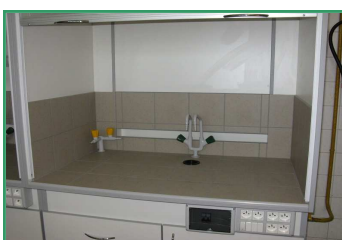
DIGESTOŘ LAM 12D: vyložení pracovního prostoru keramickou dlažbou
